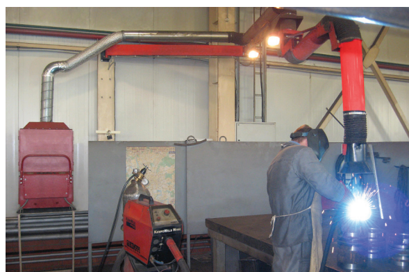
Рис. 13. Электростатический фильтр ЭФВА-1,5-13 в комплекте с консольно-поворотным воздуховытяжным устройством КПВУ-2-6,0-160 на сварочном участке.
