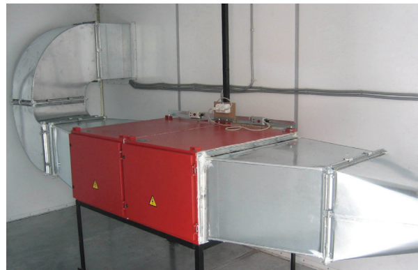
Рис. 19. Электростатические фильтры ЭФВА-2-03-МН в системе очистки воздуха ЭФВА-МН ресторана
