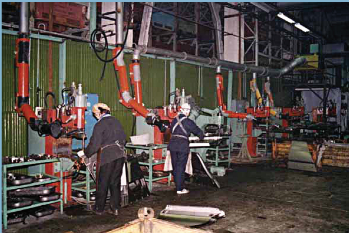
Электростатические фильтры ЭФВА-4-05 и воздуховытяжные устройства ПВУ-3 на участке контактной сварки
