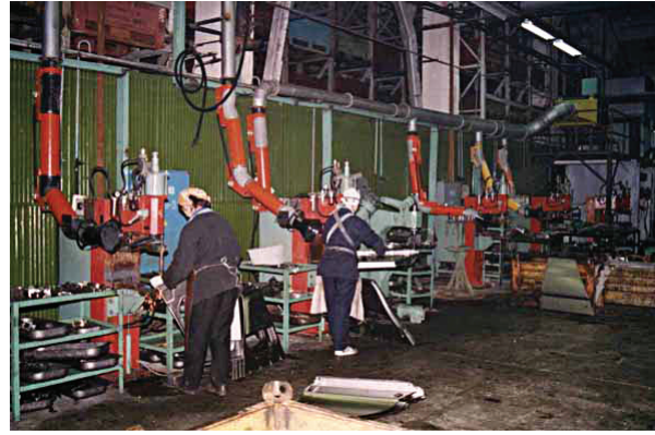
Рис. 15. Электростатический фильтр ЭФВА-4-05 и воздуховытяжные устройства ПВУ на участке контактной сварки.
