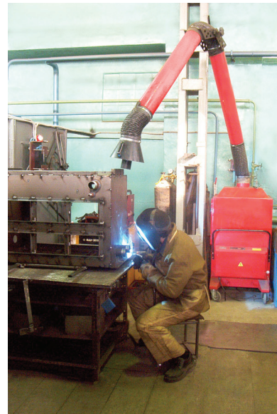
Рис. 17. Электростатический фильтр ЭФВА-1,5-11 в комплекте с воздуховытяжным устройством ПВУ-НК. Сварочный участок.
