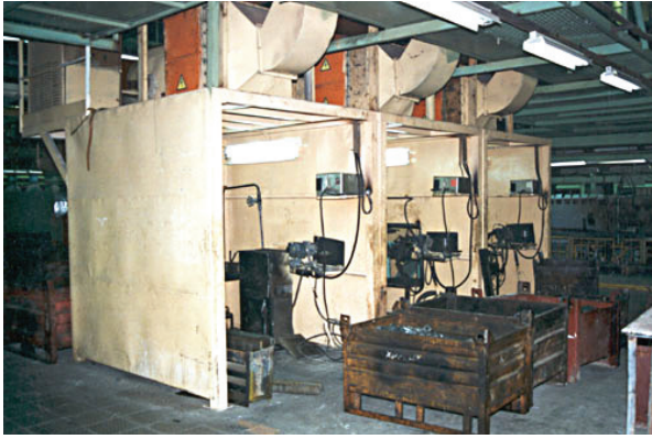
Рис. 14. Сварочные кабины, с электростатическими фильтрами ЭФВА-4-05.
